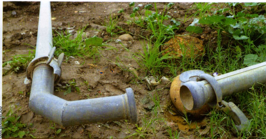
■ Près de 50 % de l'eau d'irrigation est perdue suite au mauvais entretien des réseaux.
